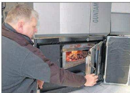
Ein Blick in den Heizkessel der Guntamatic-Technik.
